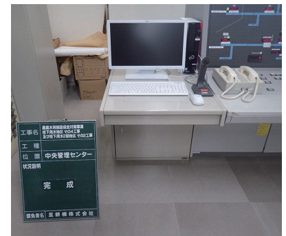
中央管理センター 映像監視装置の更新
